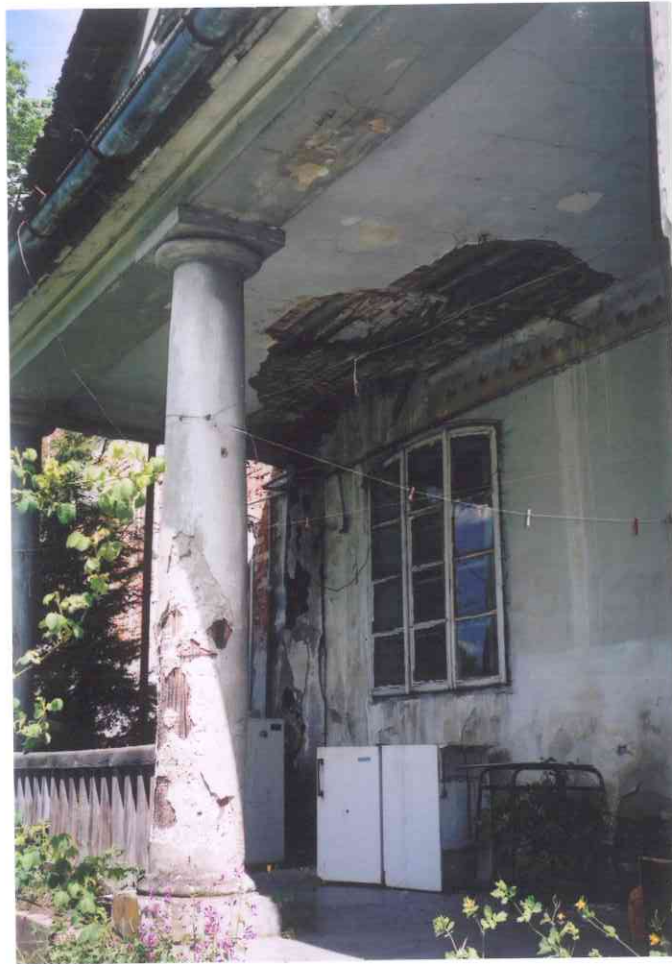
21. Fragment zniszczonego portyku w elewacji tylnej
