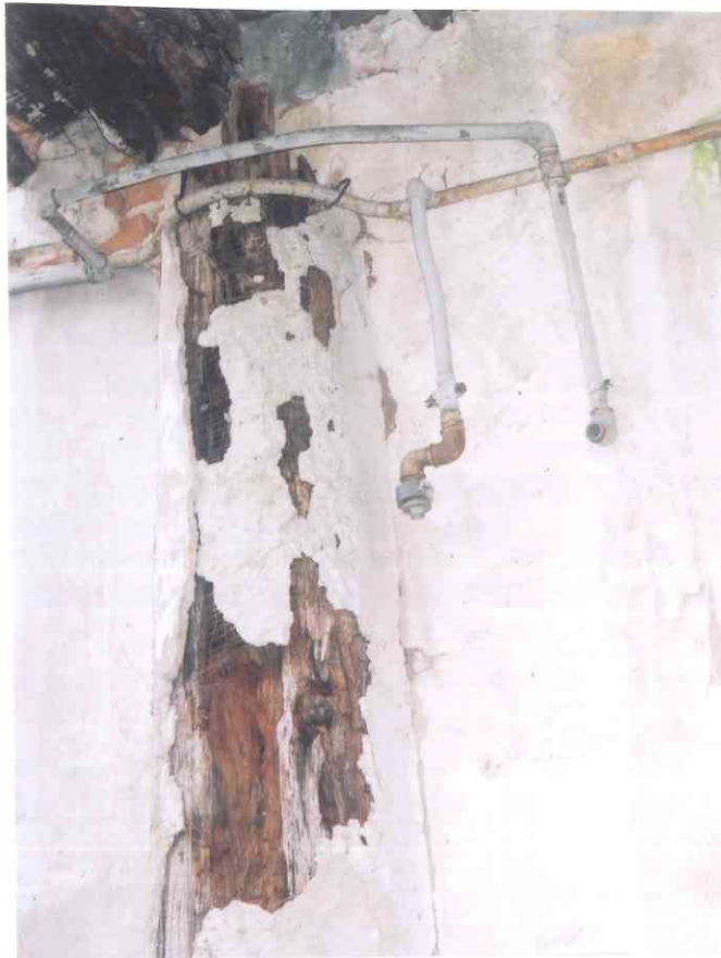
55. Zniszczony strop i półkolumna w portyku ogrodowym
