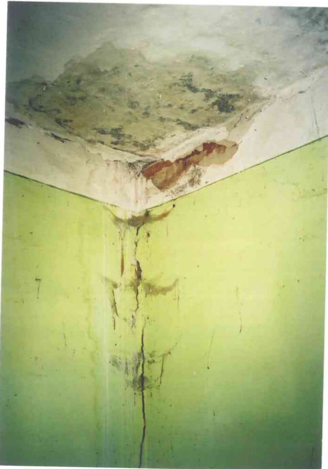
44. Zawilgocony sufit, rysa pęknięcia ściany na piętrze
