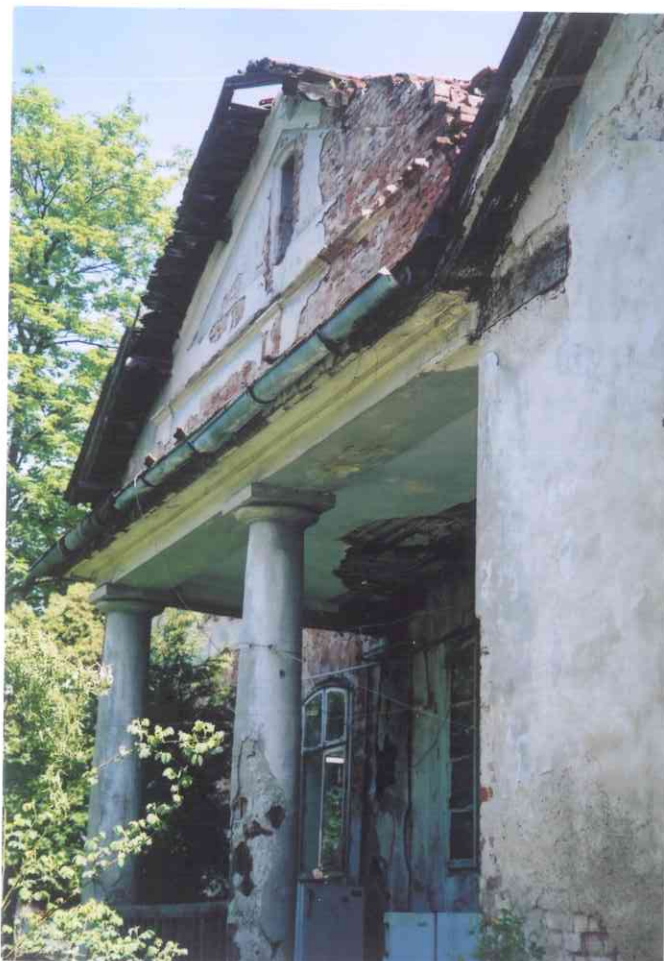
19. Zniszczony szczyt portyku w elewacji tylnej
