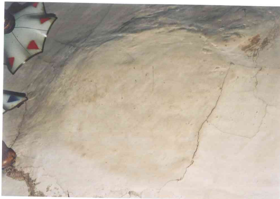
47. Ślad po zniszczonej rozecie na suficie na parterze
