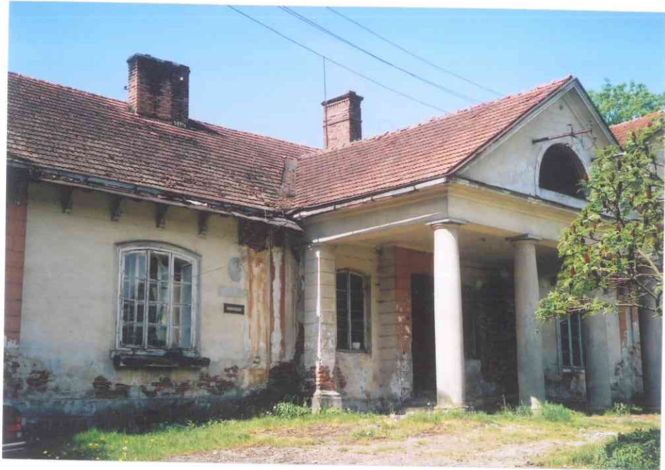
13. Fragment elewacji frontowej z portykiem ze zniszczeniami
