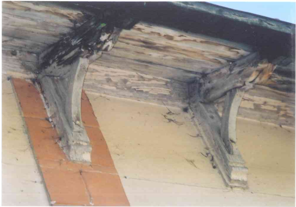
31. Zawilgocone odeskowanie okapu oraz krokwi i wsporników
