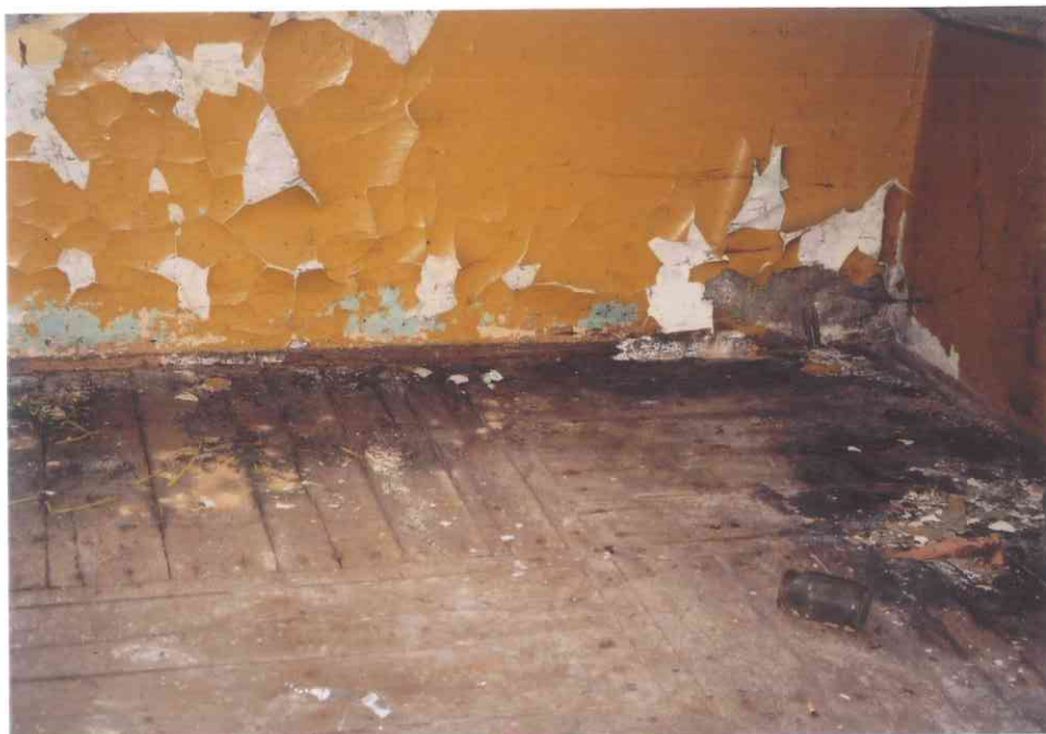
45. Zniszczona podłoga oraz łuszczenie się olejnej farby na lamperii
