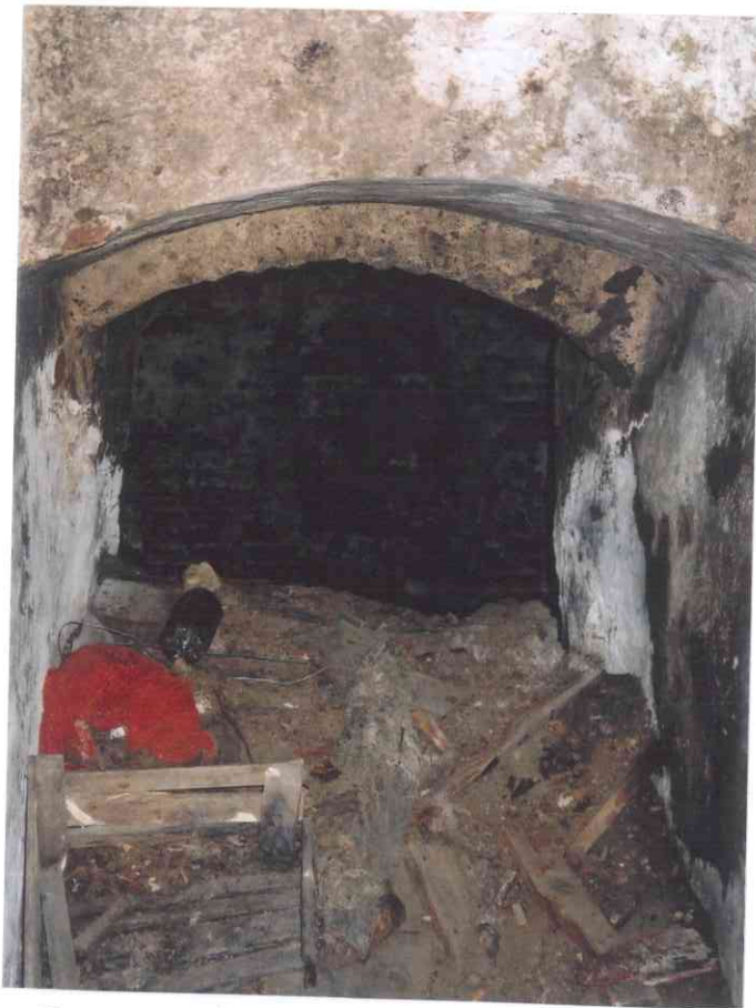
59. „Zagracona” część piwnic
