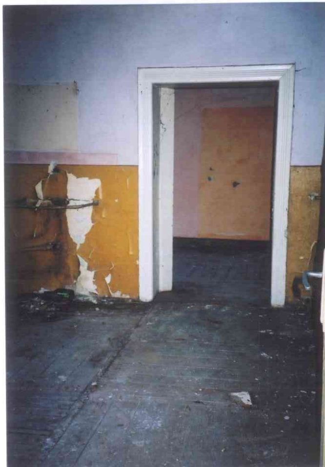
41. Ślady zawilgoceń podłogi na piętrze
