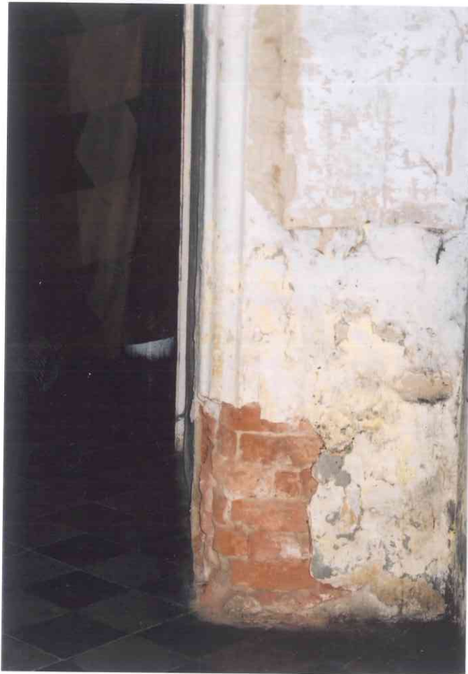
51. Zniszczona ściana w nieużytkowanym pomieszczeniu parteru
