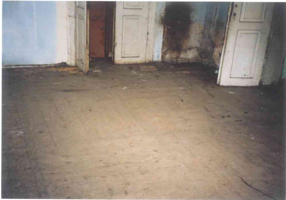
43. Ślady zawilgoceń podłogi i ścian na piętrze
