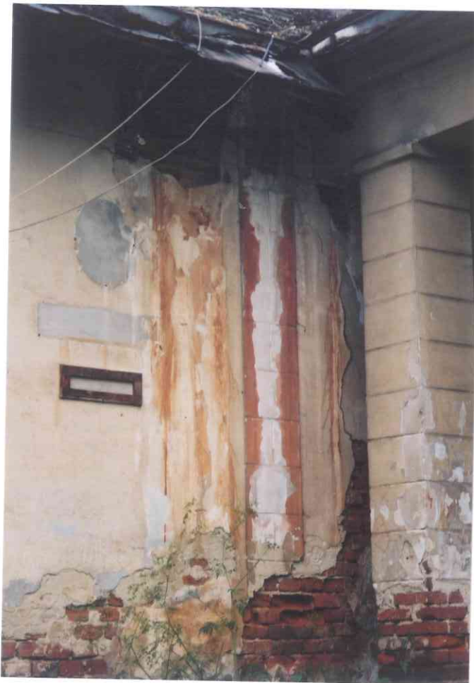
14. Ślady zamknięcia ścian i ubytków tynków koło portyku w elewacji frontowej
