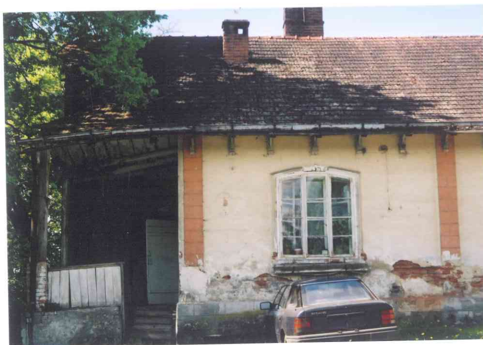
16. Wsch. – płd. część elewacji frontowej ze śladami zniszczeń
