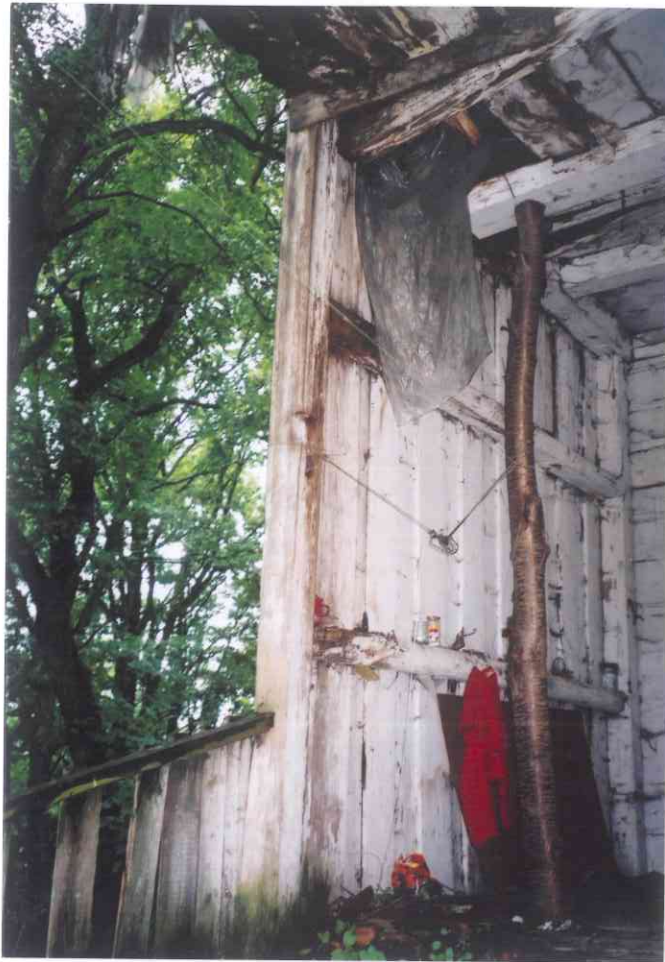
25. Przegnity strop i zawilgocone ściany na tarasie bocznym
