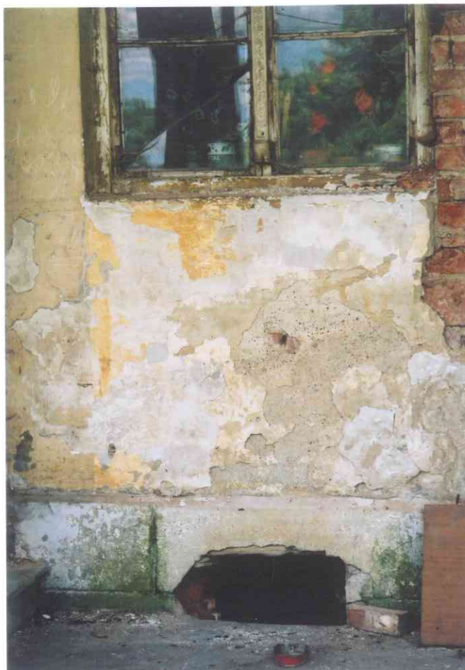
15. Łuszczenie się farby i ubytki tynku na ścianie w elewacji frontowej
