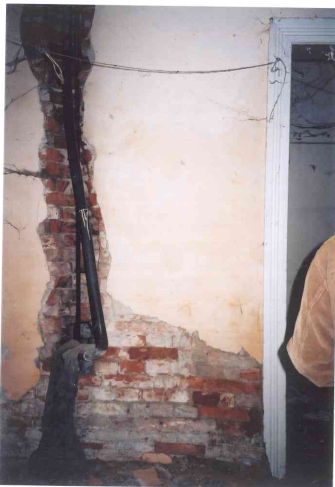
50. Zniszczona ściana na parterze po wykonaniu instalacji kanalizacyjnej
