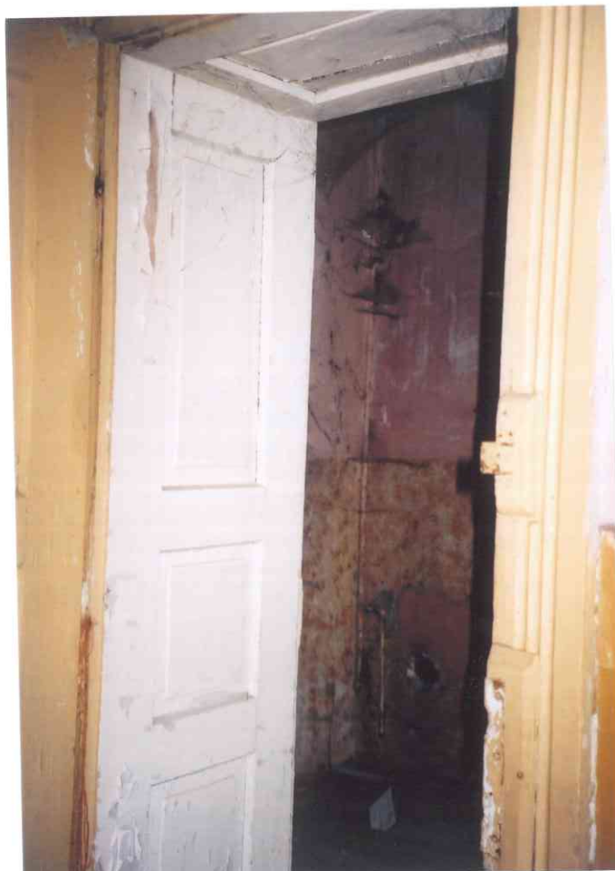
42. Zniszczona stolarka drzwiowa na piętrze
