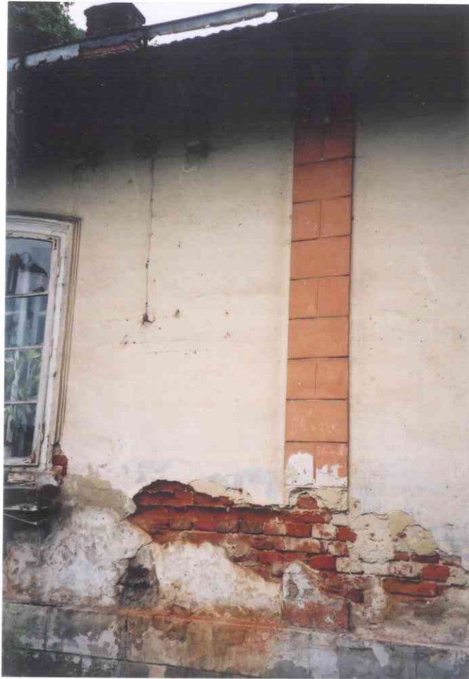
17. Fragment zniszczonej ściany w elewacji frontowej
