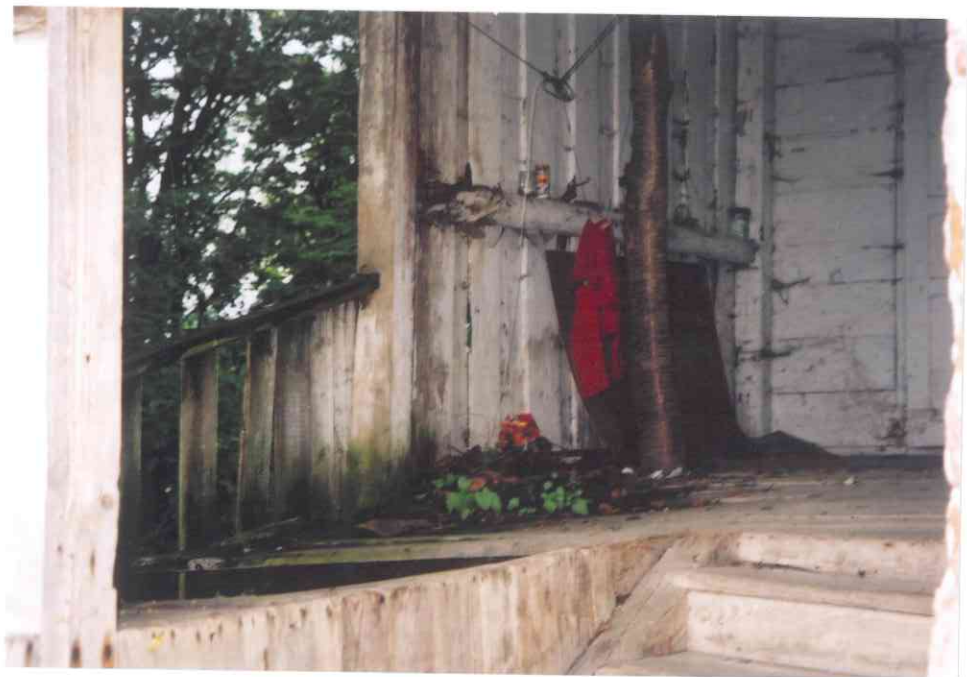
24. Fragment zniszczonej balustrady i podłogi na tarasie bocznym
