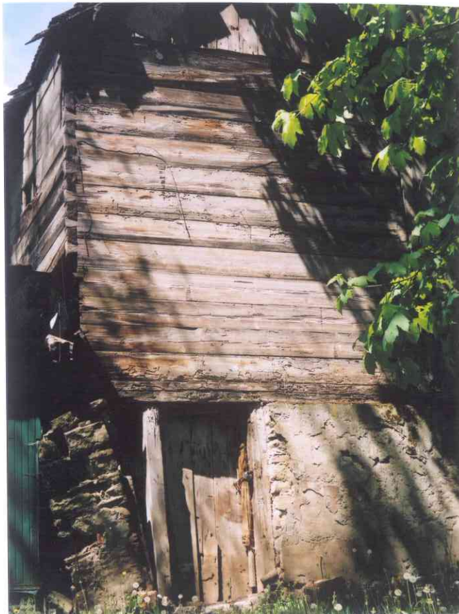
26. Fragment zniszczonych przez drewnojady belek na ścianie bocznej tarasu
