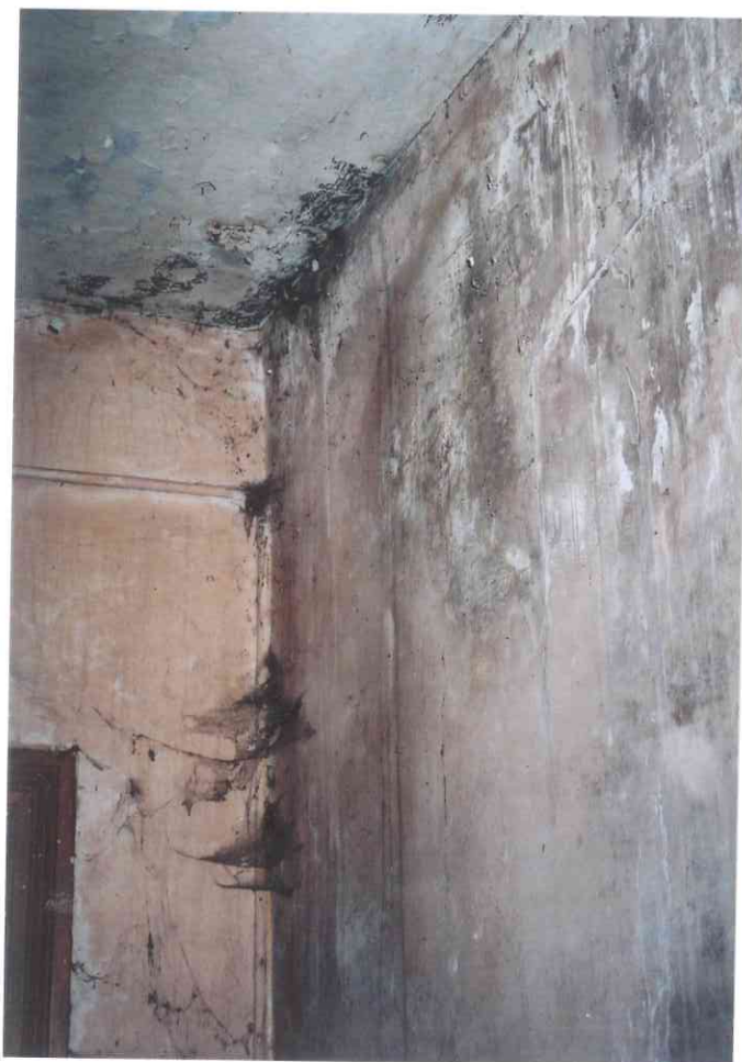
40. Zawilgocone pomieszczenie na piętrze
