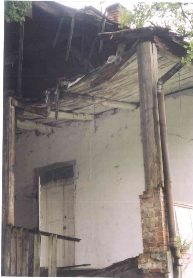
23. Fragment zniszczonego drewnianego tarasu bocznego przez drzewo – wiatrołom
