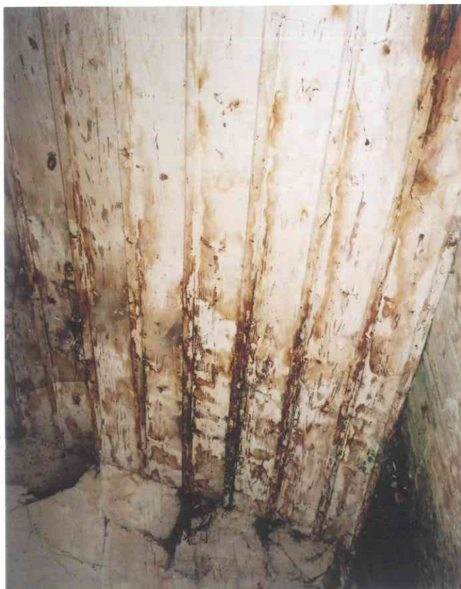
37. Odeskowany sufit na piętrze w klatce schodowej, przegnity
